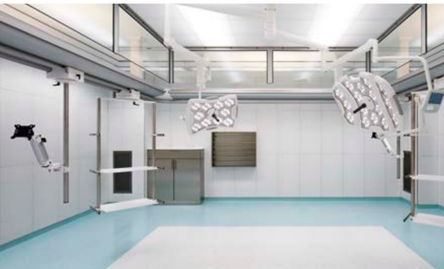
Glaçures spéciales pour l'utilisation de lasers dans les salles d'opération Krankenhaus der Barmherzigen Brüder, Munich, Allemagne / Architecte : Generalplanung Architekt Szauer, Eisenstadt, Autriche / Photo : Monika Custodis
