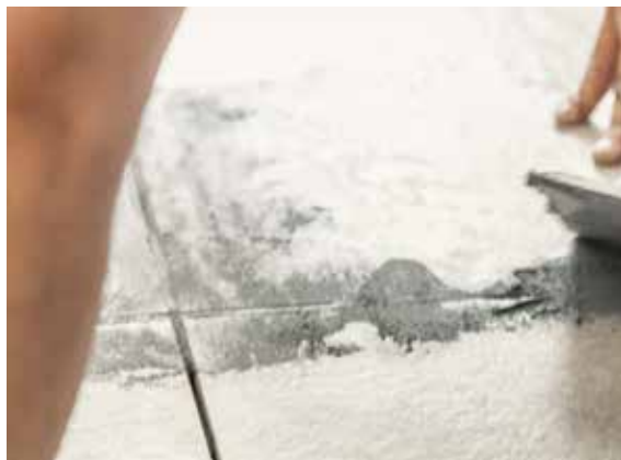
4 Fliesen mit systemeigener Fugenmasse verfugen. Wichtig ist dabei das richtige Mischungsverhältnis der Fugenmasse mit Wasser gemäß Angaben des Herstellers.
