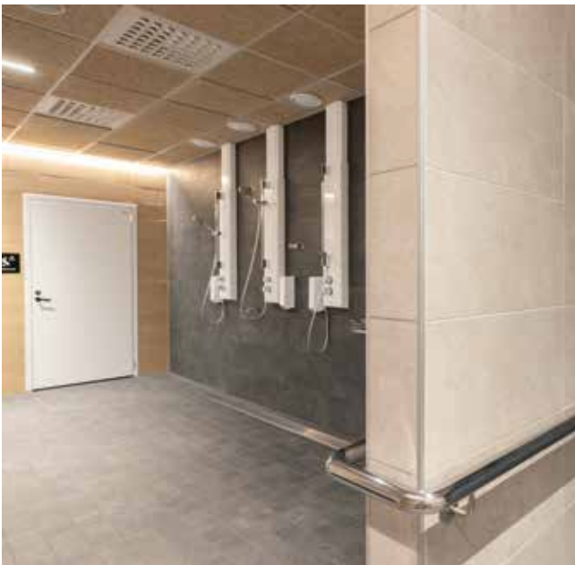
Piscine couverte Linnanmaa, Oulu, Finlande / Architecte : Arktes Oy Série : Ascona / Photo : Lumo Image / Petteri Löppönen
